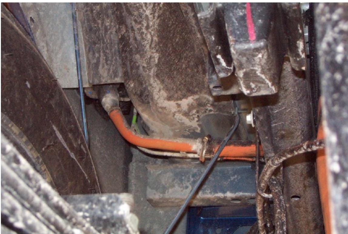
29. Tuyau de remplissage et vapeur. Filler and vapor pipe.
