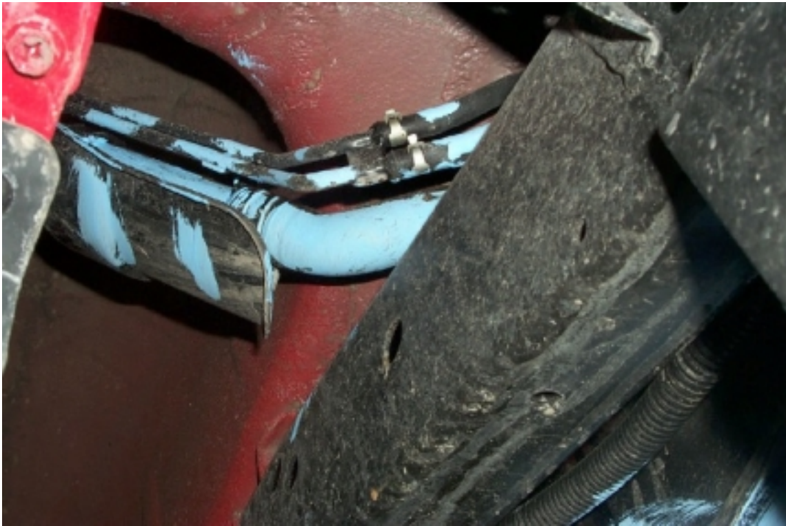
35. Tuyau de remplissage et vapeur.
